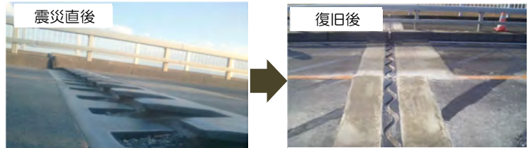
震災直後 東日本大震災により、橋桁の接続部に生じた段差
