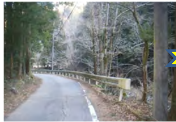
道路の幅が狭く、災害時に緊急車両の通行が困難
