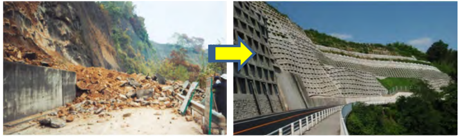
法面崩壊状況 (H7. 11. 13 降雨のない中で突然崩壊)
