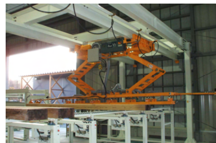
木材吸着搬送設備
