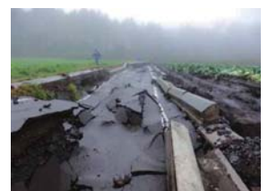
台風による農道の損壊
