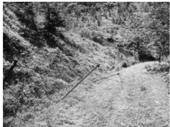
図-8 崩落による支柱の倒壊
