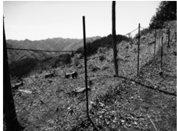
図-6 飛び込みによる柵上部のネット下がり
