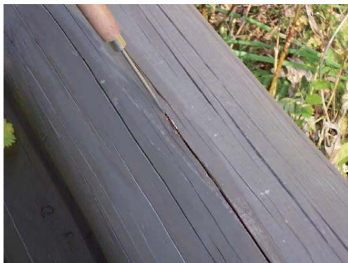
写真-1 被害度1の劣化状況
