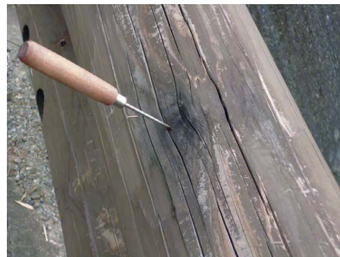
写真-2 被害度2の劣化状況
