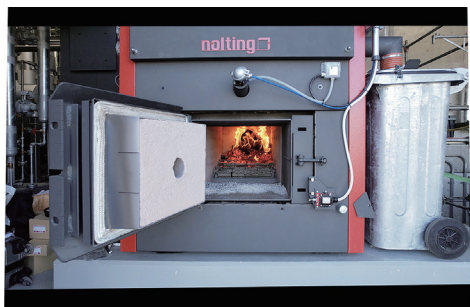
木質バイオマスボイラー本体内部
