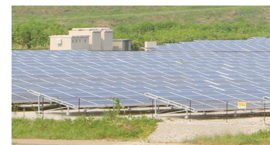
太陽光発電所
