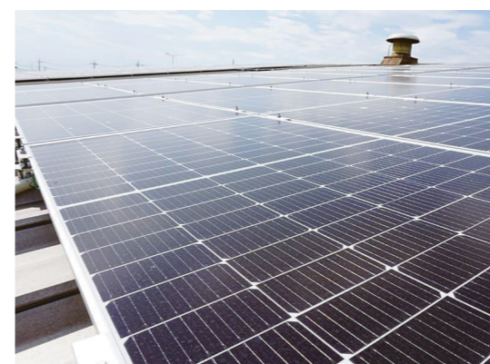
工場の屋根に設置されたソーラーパネル
