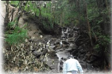
土石堆積状況
