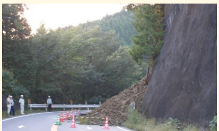
事業前の状況 (H18.10発生の斜面崩壊)
