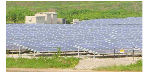
太陽光発電所
