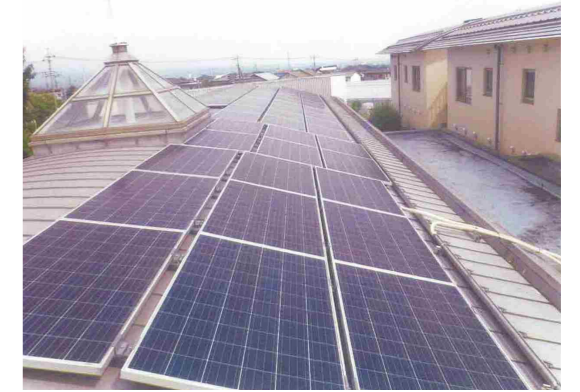
発電した電力を施設内で活用
