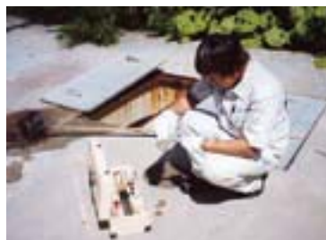
△ 浄化槽の管理作業
