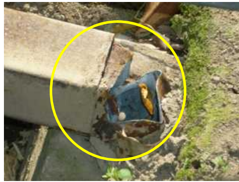
【 柱鉄骨の基礎の腐食 】
