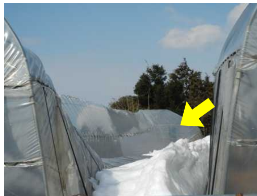
【 側圧による倒壊 】
