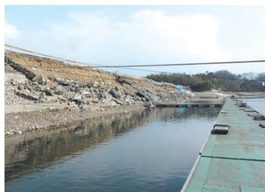
地震により被災した防災重点ため池（藤岡市：大谷池）
