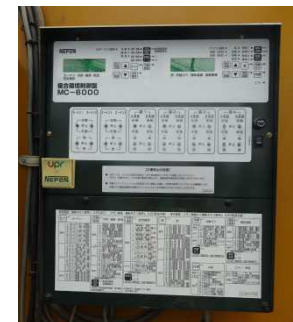
複合環境制御盤*5
