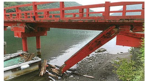
写真2：神社側の橋桁落下状況
