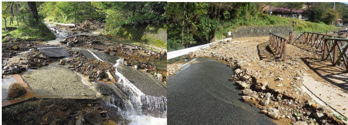
【下仁田町内の被害状況】
