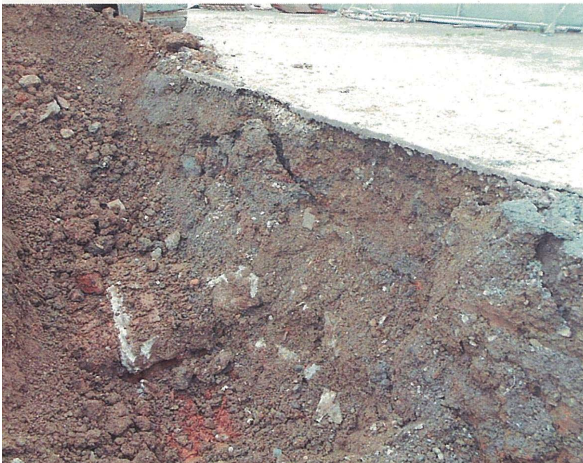
建物解体に伴う掘削にて発見された埋設物
