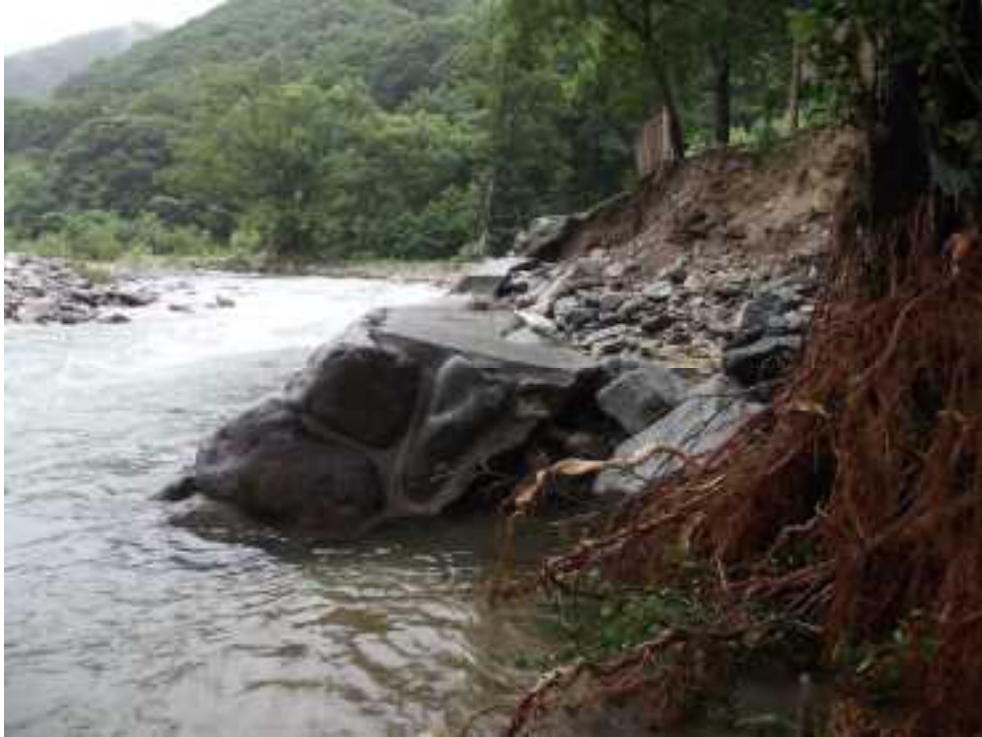
湯桧曾川(湯桧曾公園脇) 被災状況 (みなかみ町)
