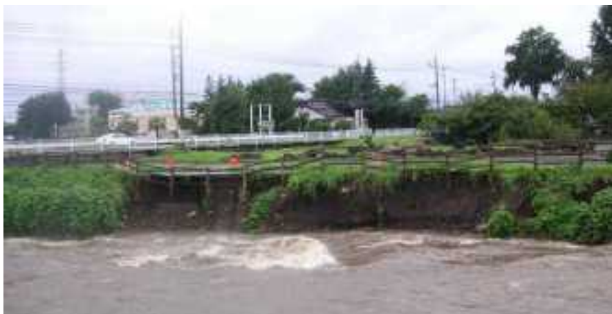
台風第12号による被災状況写真
