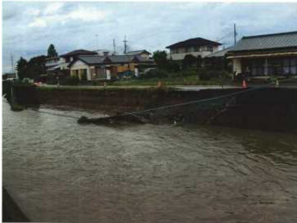
大川護岸崩落状況（伊勢崎市）
