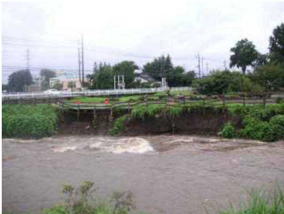
早川護岸崩落状況（伊勢崎市）
