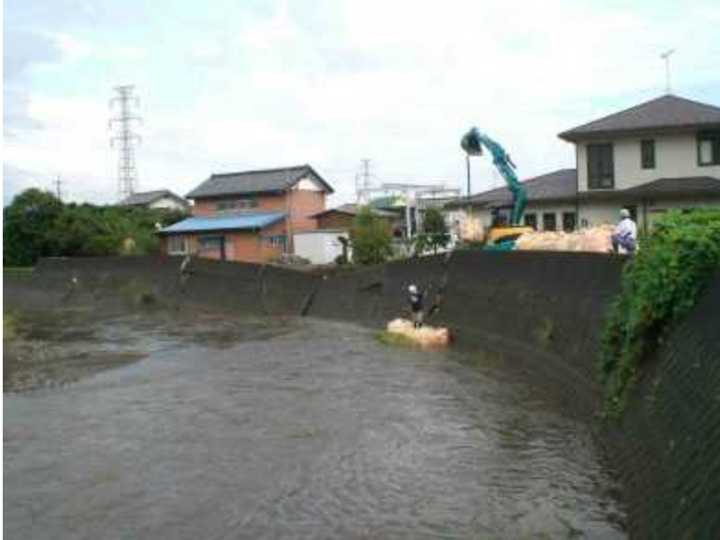
染谷川護岸崩落状況（高崎市）
