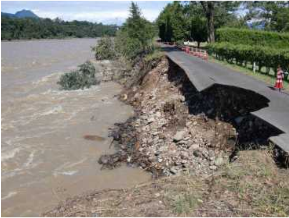
利根川 被災状況（前橋市）
