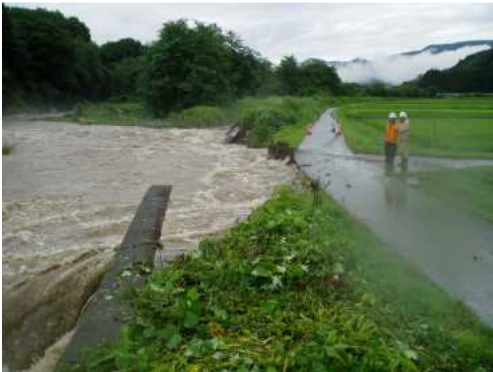
薄根川 被災状況 (川場村)
