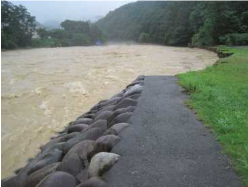
利根川(銚子橋下流) 被災状況 (みなかみ町)
