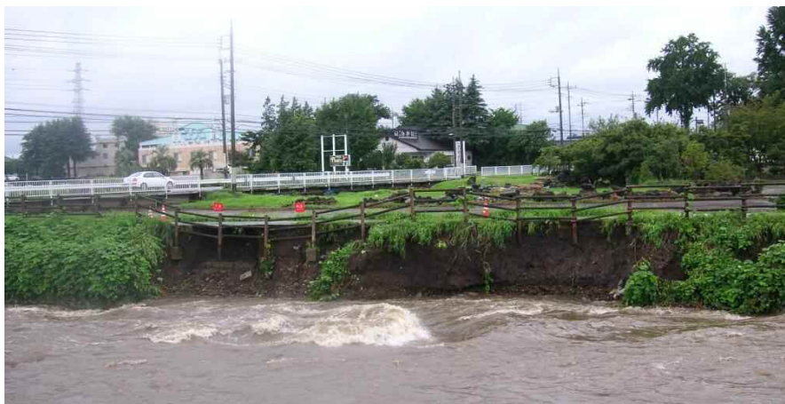
台風第12号による被災状況写真
