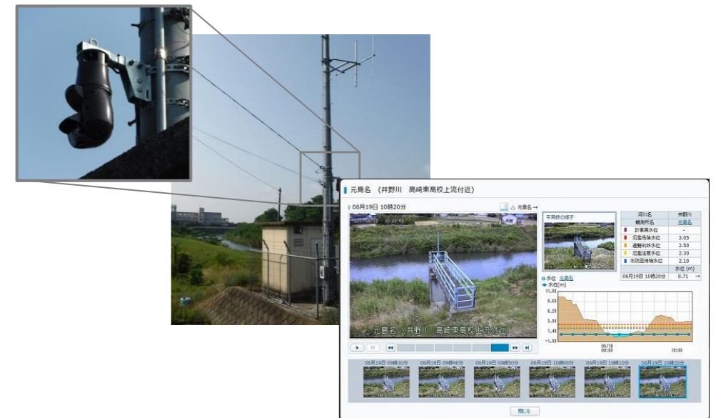
洪水監視カメラ・水位雨量情報システム（群馬県）
