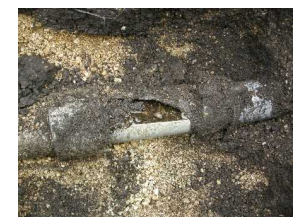
5 追分地区 【石綿セメント管破損状況】
