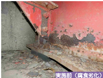
実施前（腐食劣化）
