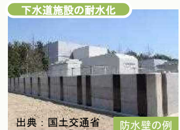
下水道施設の耐水化
