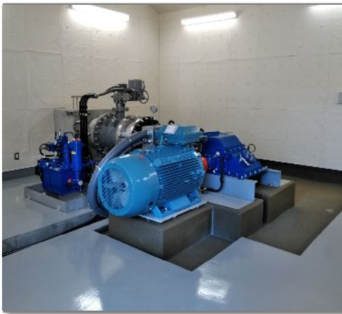
水車発電機（クロスフロー水車）
