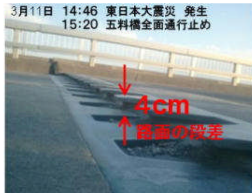
五料橋の路面に4cmの段差発生=3/11
