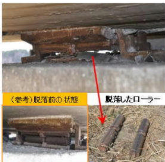
鋼製ローラー支承の損傷を確認=3/12
