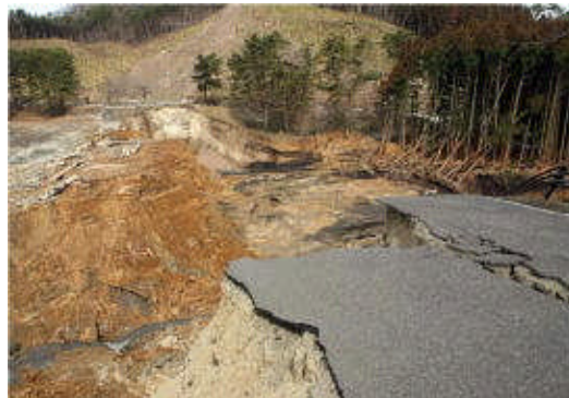
堤体決壊状況
