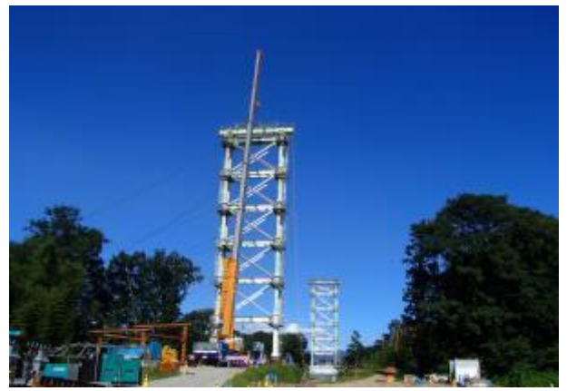
祖母島～箱島BP (仮称) 岡崎ICランプ橋上部工工事 8/9撮影
