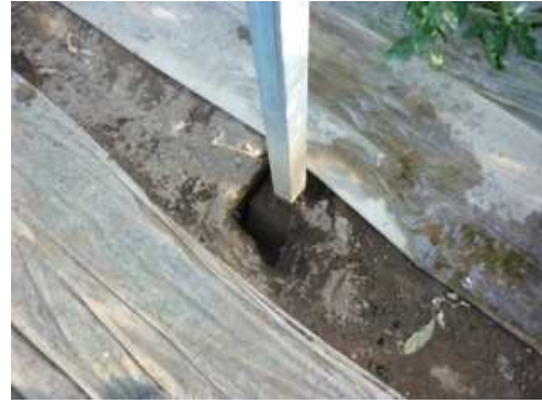
【 基礎の沈み込み 】
