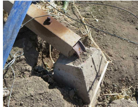
【 柱と基礎部の強度不足 】
