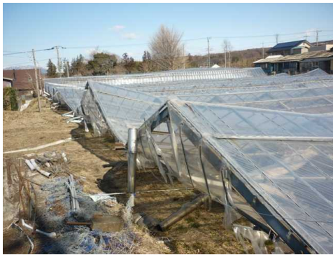
【 鉄骨ハウス倒壊 】
