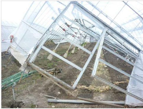
【 ハウスの一部の歪みに引っ張られる形で倒壊 】
