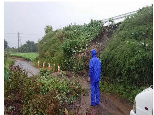
⑥R1.10 台風19号法面崩落・土砂流出(引間町)
