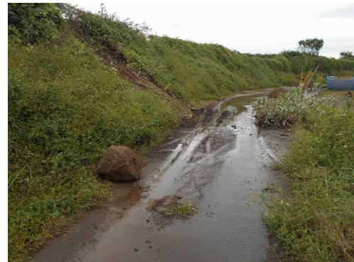
④H29.10 台風21号法面崩落・土砂流出(引間町)
