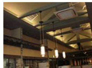
空気換気設備 （店内）
