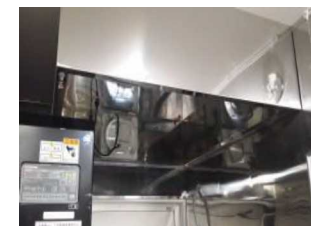
空気換気設備 （調理場）
