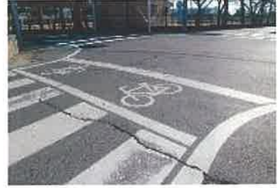
③ひび割れた道路(赤岩地内)
