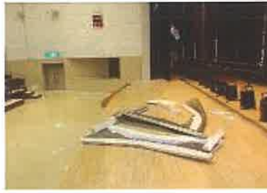
②天井が一部崩れたプラザ・ホール
