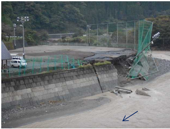
神流川 被災状況（神流町万場）
