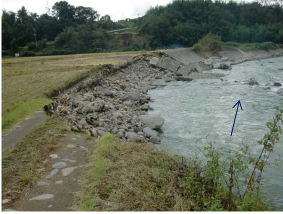
碓氷川 被災状況（安中市松井田町）
