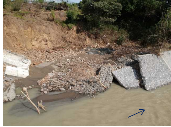
鎗川 被災状況（富岡市星田）
