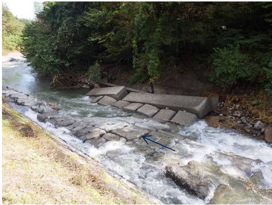
須川川 被災状況（みなかみ町西峰須川）
