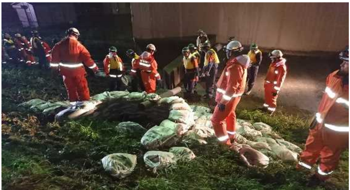
館林地区消防組合 明和消防団等による水防活動(月の輪工)状況 (明和町須賀)
