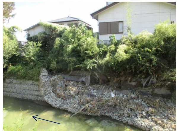
大沢川 被災状況 (高崎市吉井町)
