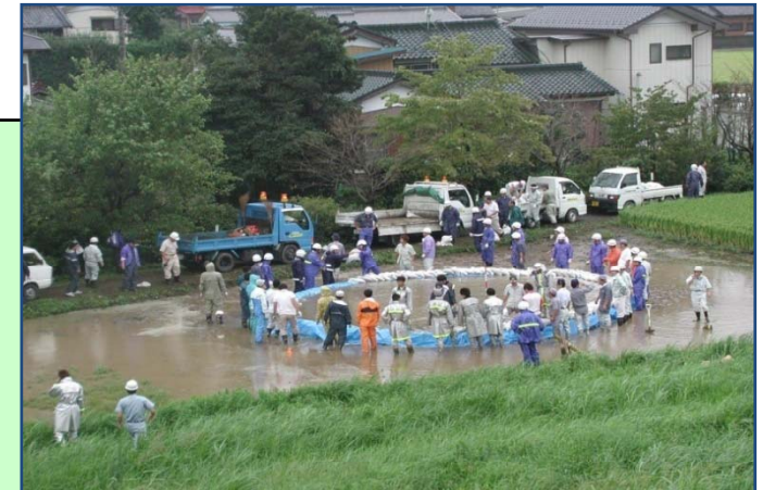
●埼玉県加須市漏水状況(H13台風15号)
