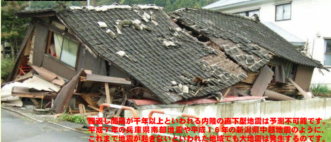
新潟県中越地震で倒壊した住宅
