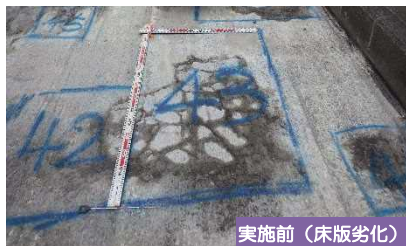
実施前（床版劣化）
