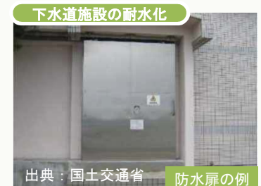
下水道施設の耐水化
