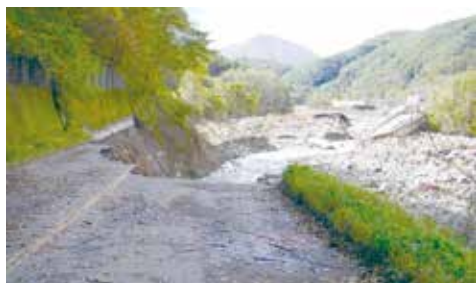
昨年の台風第19号による被災状況(嬬恋村)
