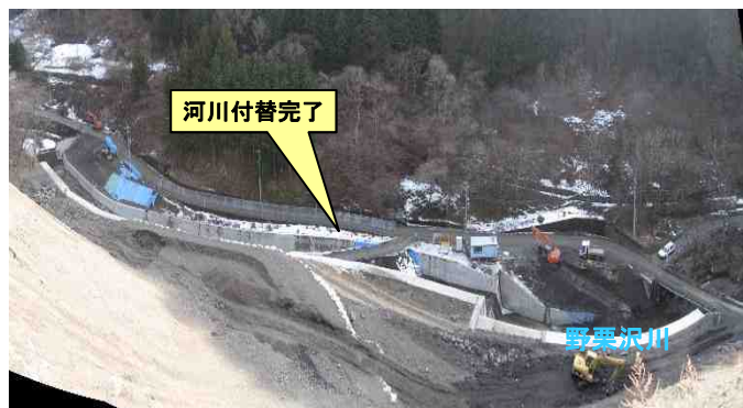
崩壊下部河川状況
