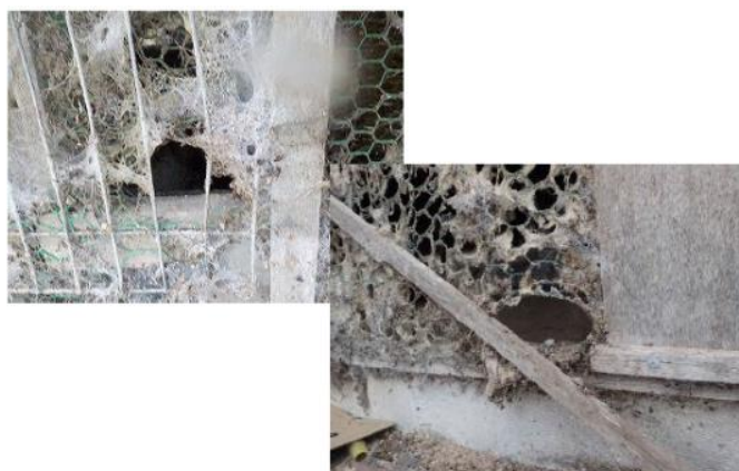
鶏舎開口部の金網の破損・湾曲
