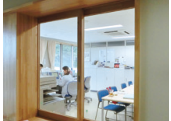
地中熱空調システムが導入された事務室
