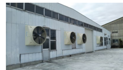
工場に導入した大型換気設備
