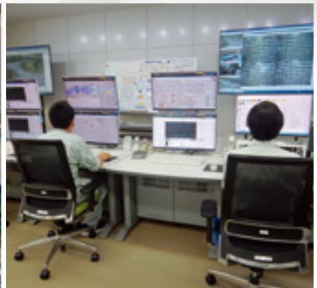
浄水場を監視する職員（県央第二水道事務所）
