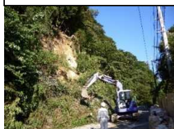
国道122号 斜面崩壊による通行規制(H23)
