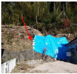
がけ崩れ状況 (H29年10月)
