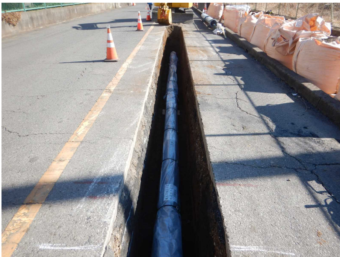
東毛工業用水道事務所 館林工業団地配水管路布設替工事
