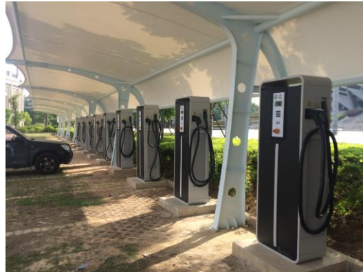
ズラリとならぶ充電装置 (事務所スタッフが住むマンション敷地内)
