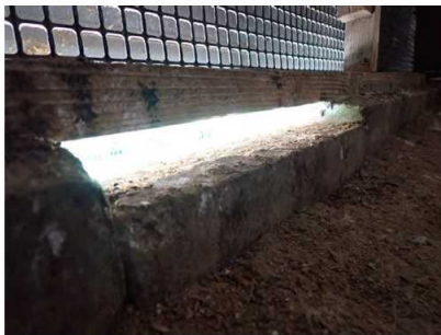
発生鶏舎排水口の閉鎖不全。2 cm程度の隙間あり
