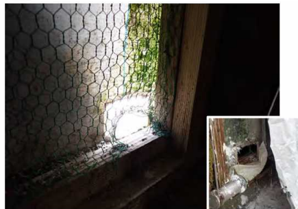
鶏舎の金網の破損部位。小動物が出入りした痕跡あり
