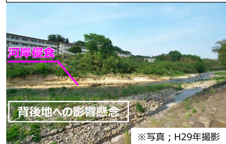
写真③河岸侵食箇所（磯部築下流）
