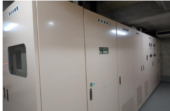
受変電・蓄発電設備
