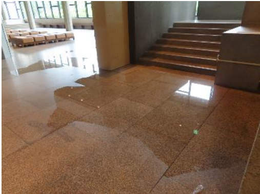
ホワイエ雨漏り（雨水配管劣化）
