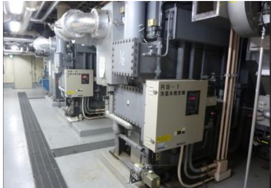
冷温水発生機（熱源）
