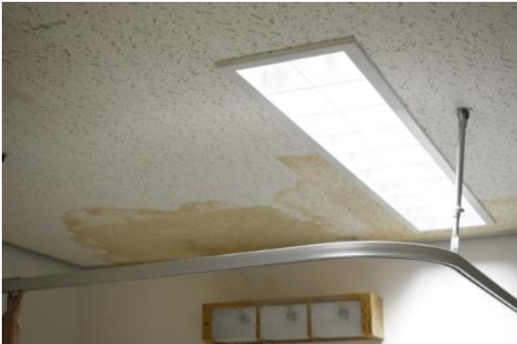
楽屋雨漏り（屋根防水機能劣化）
